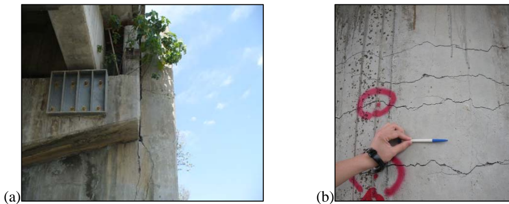
圖 2-1 高美大橋裂隙狀況(a)橋臺(b)橋柱 (國家地震工程研究中心)
