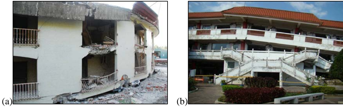
圖 2-2 (a)臺南新化球場旁三層樓建物，因下方樑柱斷裂倒塌 (b) 高雄縣內門紫竹寺活動中心因一樓倒塌而傾倒 (國家地震工程研究中心)
