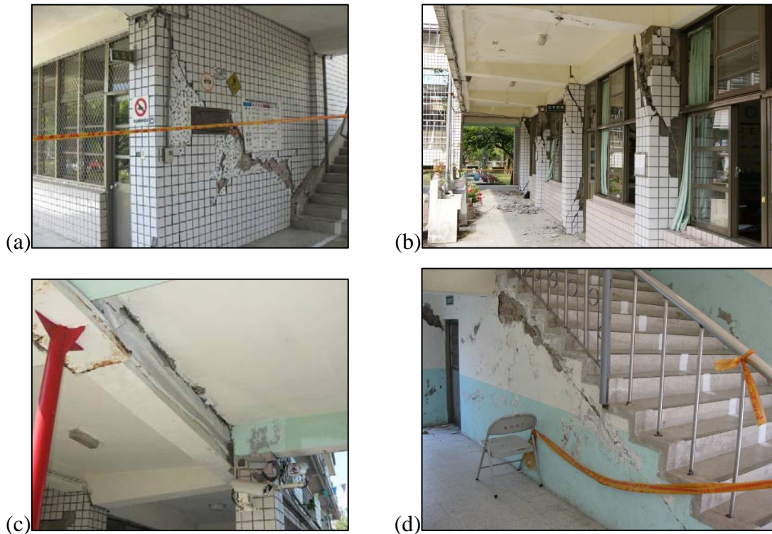
圖 2-3 玉井國中校舍損毀狀況 (a)忠孝樓牆面損毀 (b)仁愛樓樑柱與牆面破壞 (c)文化樓樓版破壞 (d)信義樓樓梯破壞狀況 (國家地震工程研究中心)
